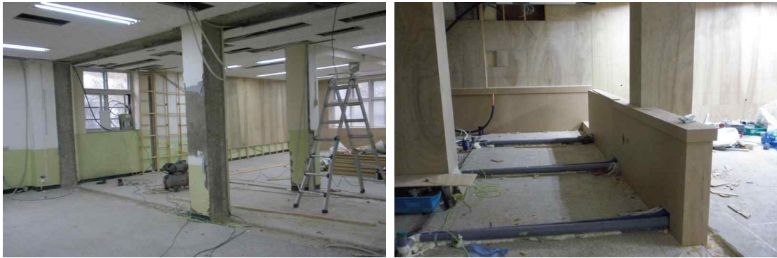
[그림 Ⅲ-7] 공사 중 발생했던 문제 상황
