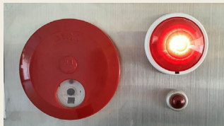
P형 발신기와 표시등
